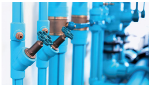
Оборудование для водоснабжения
